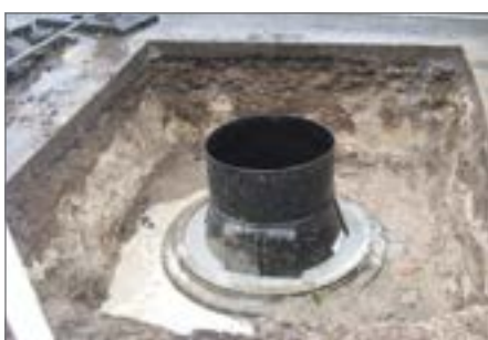
11.) Wypełnienie przestrzeni pomiędzy studnią PE DN 800 a studnią betonową DN 1000 zaprawą wypełniającą
