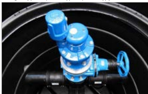
Kanał główny jako odpowietrzająco-napowietrzający
