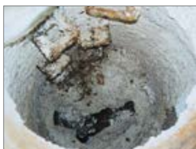
Skorodowana studnia betonowa
