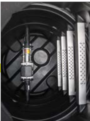
Studnia wodomierzowa ze zintegrowanym miernikiem przepływu MID
