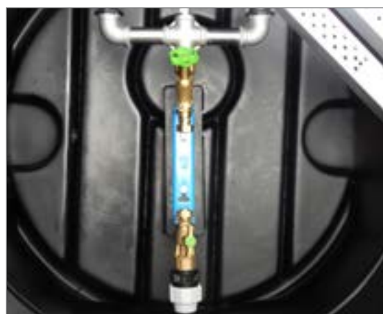
Studnia wodomierzowa z rozdzielaczem
