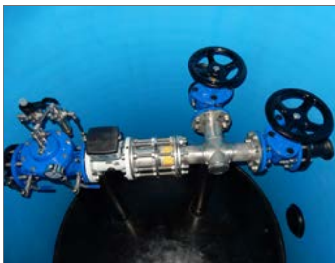
Studnia z wodomierzem i reduktorem ciśnienia
