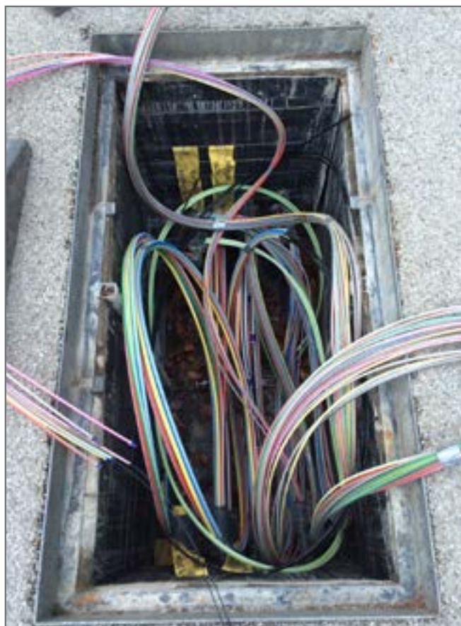
Zabudowana studnia z różnymi rodzajami okablowania
