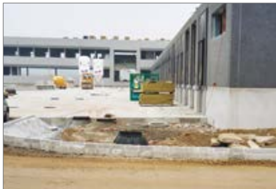
ALDI Centralny Magazyn: okablowanie dla oświetlenia.
