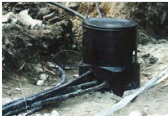
Zarząd Lasów: wymaganie całkowicie szczelnych studni kablowych dla instalacji wzdłuż leśnych dróg.
